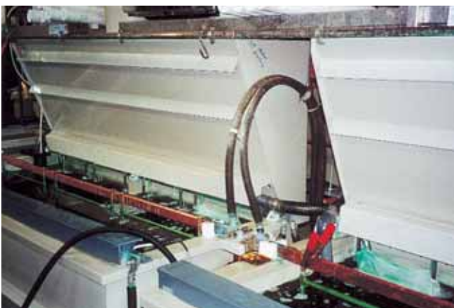
Abb. 9: Wandabsaugungen an Beschichtungsbehältern
