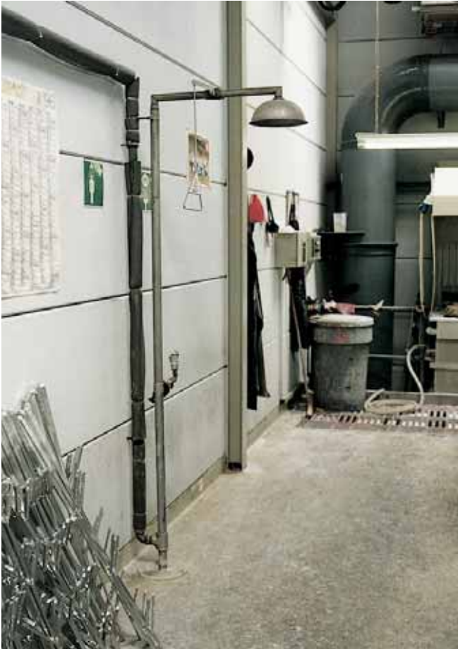
Abb. 12: Notdusche in einem Arbeitsbereich mit Verätzungsgefahr
