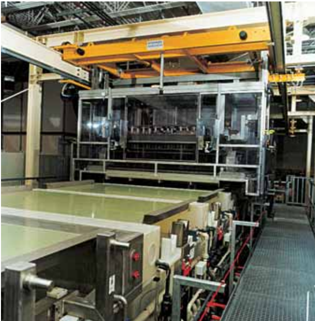
Abb. 8: Automatische Anlage mit Lüftungskabine am Transportwagen (Quelle: Fa. Stohrer-Duduco)
