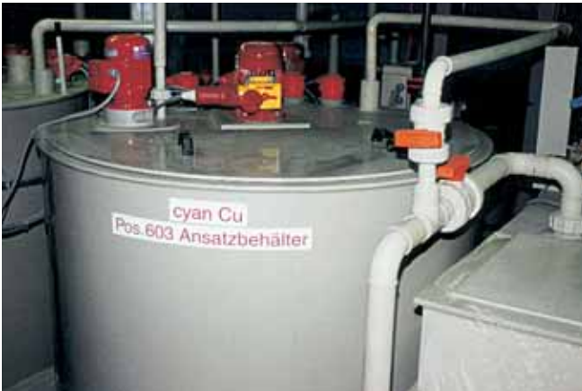
Abb. 6: Fertigansatz für die Versorgung von Behandlungsbehältern
