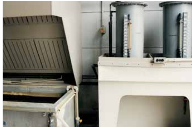
Abb. 7: Versorgung von Behandlungsbehältern aus einem geschlossenen Befüllsystem
